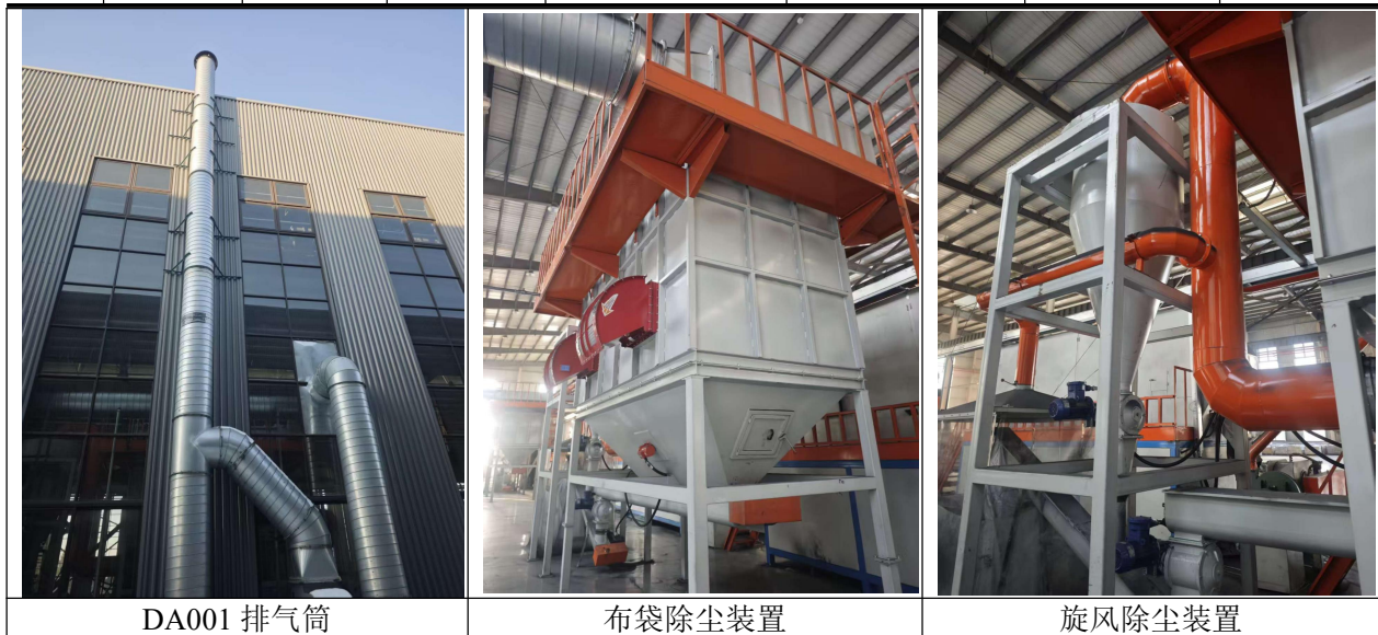
图 4.1-1 废气收集处理设施片
