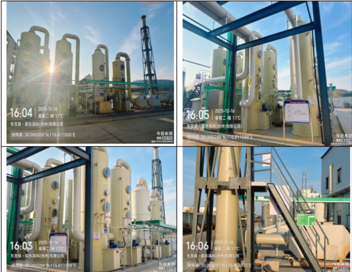
污水处理站废气处理设施及废气排放口 (DA004)
