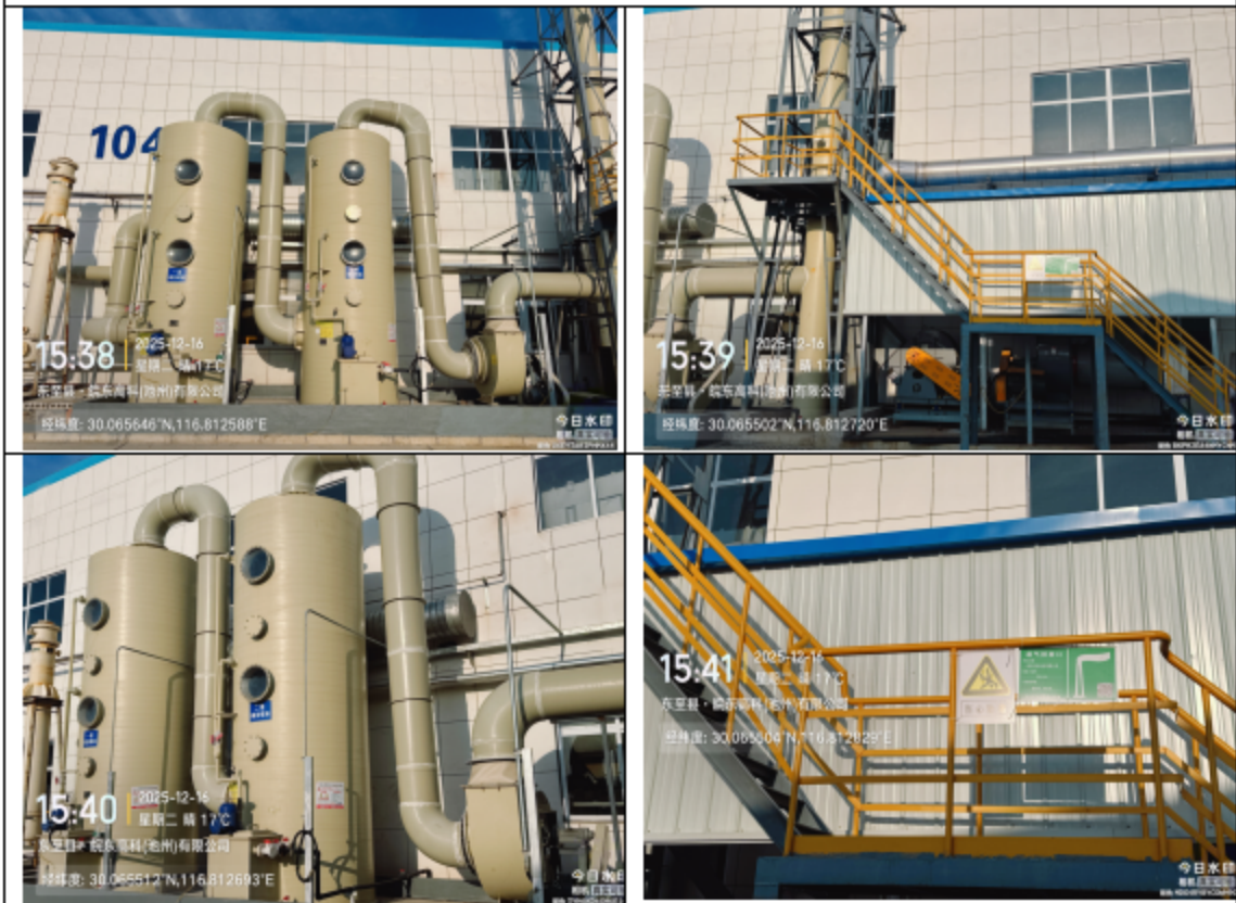
厂区硫酸镁生产车间废气治理设施及排放口 (DA005)
