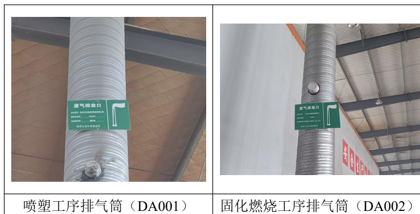
图 3-2 废气排放口标志牌
