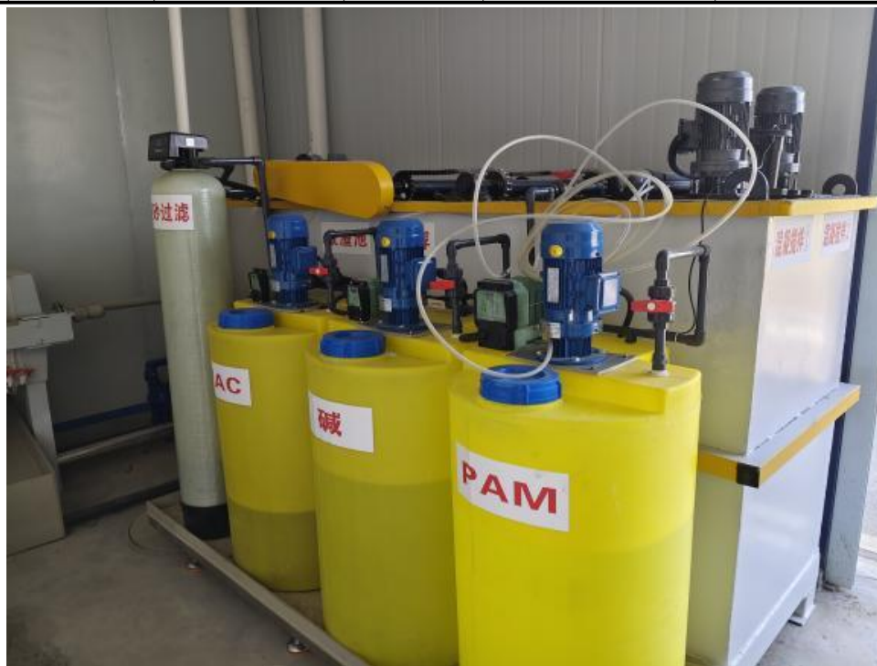
图 3-1 废水处理设施
