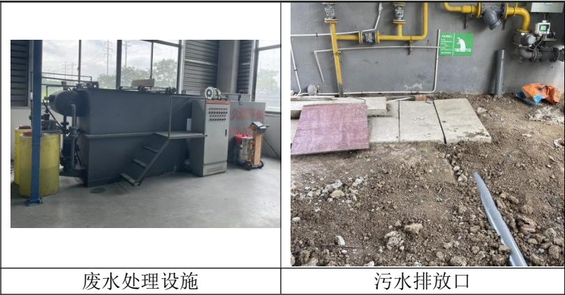
图 3-5 废水处理设施
