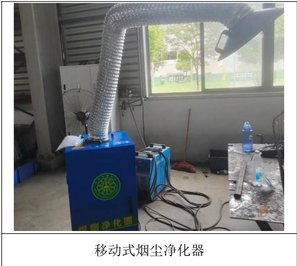
图 3-1 焊接烟尘处理设施
