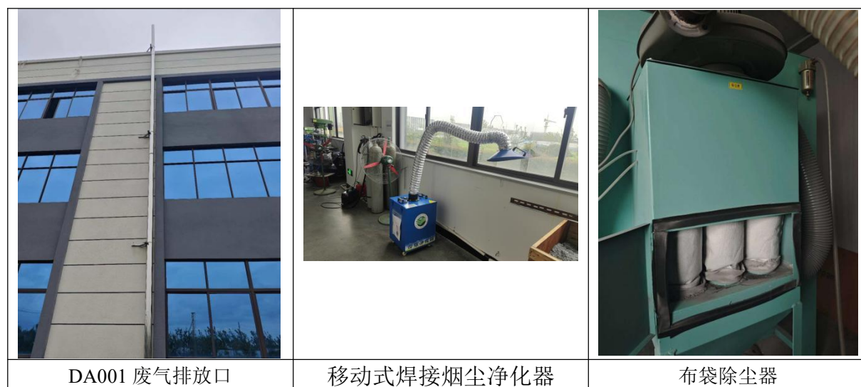
图 3-1 废气处理设施
