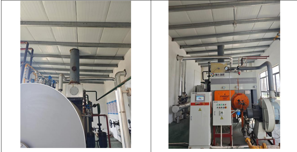
锅炉废气排放口
