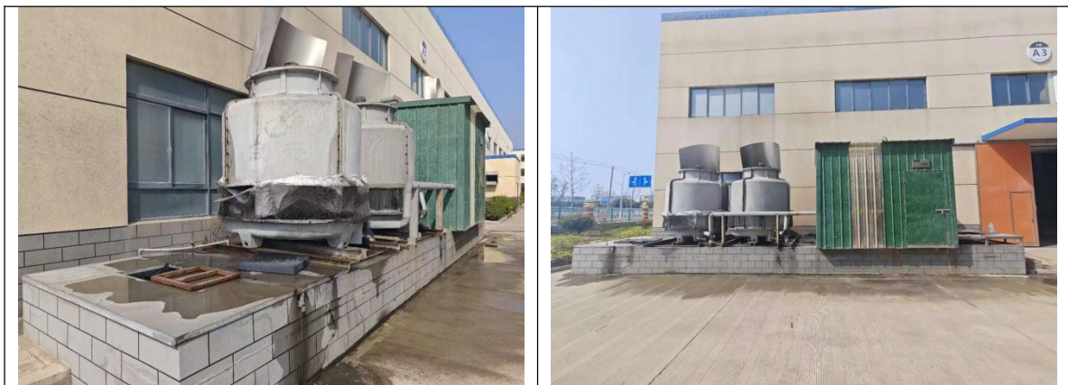
冷却塔+沉淀池
