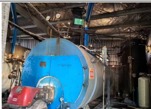
低氮燃烧器+DA002 排气筒
