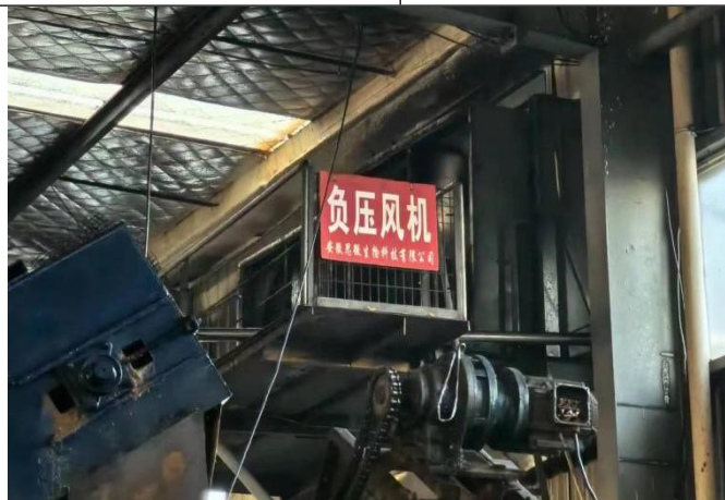
车间废气收集措施
